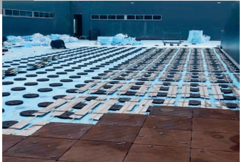
Het dak is een pilotproject voor verwarmde parkeerdaken. Het Pardak® 80-systeem van Zoontjens wordt hier gecombineerd met verwarmingsbuizen, rvs-profielen en stroken isolatie.
