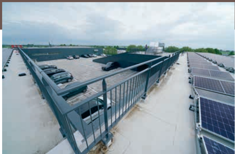
Het verwarmde parkeerdak gezien vanaf het hoogste dakniveau waar 488 zonnepanelen en de luchtbehandelingskast een plek kregen. Het hele dak is omheind met vaste hekwerken en daardoor volledig toegankelijk.
