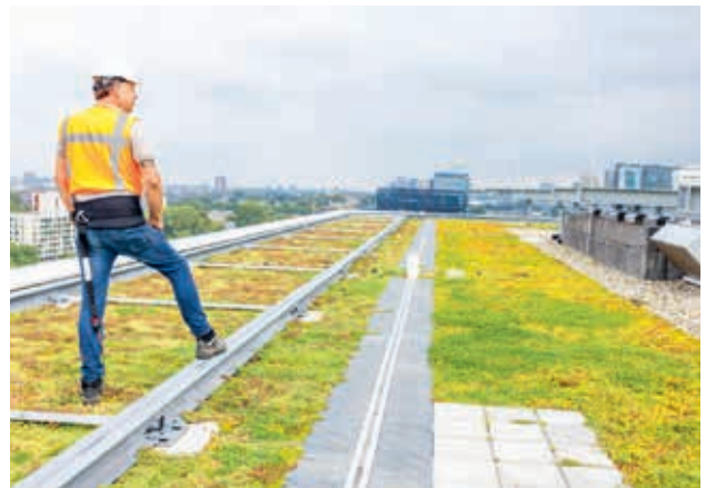
Dak van Het venster: sedum, waterretentie, glazenwasinstallatie en PV-panelen (hier nog niet geplaatst). (Foto: Van Kessel Sport en Cultuurtechniek)
