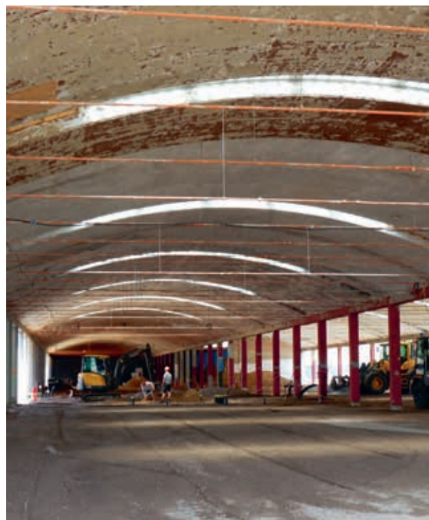
Trekstangen aan de binnenzijde zorgen voor de versteviging van de ranke dakconstructie.
