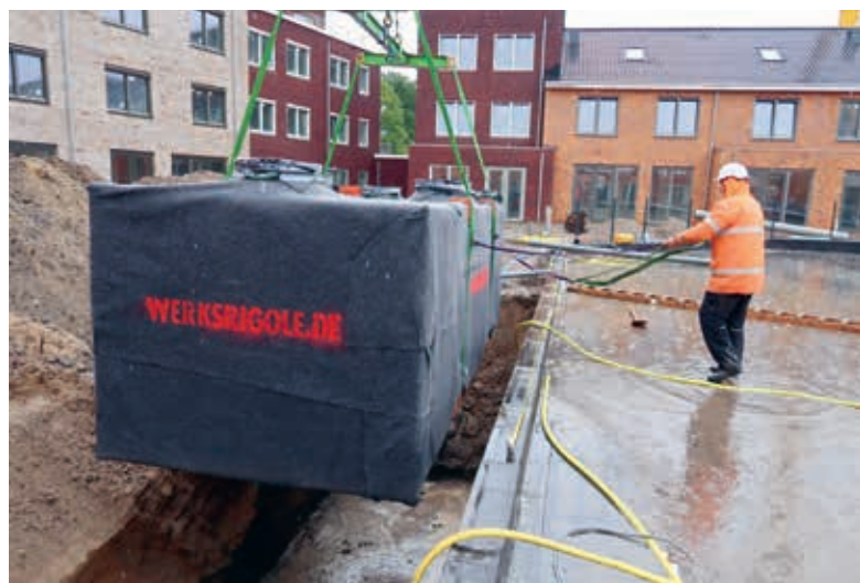
De bergingstank van 30m 3 bergt de eerste vijf minuten regenwater die komt van de daken van de woningen.
