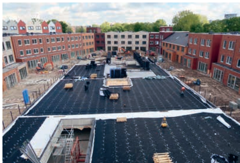
De vier verspringende retentiedaken op het dak van de parkeergarage.
