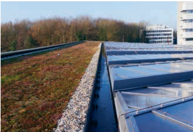
Daklichten, dakgoot, sedum. (Foto: Hegeman Bouw & Infra)
