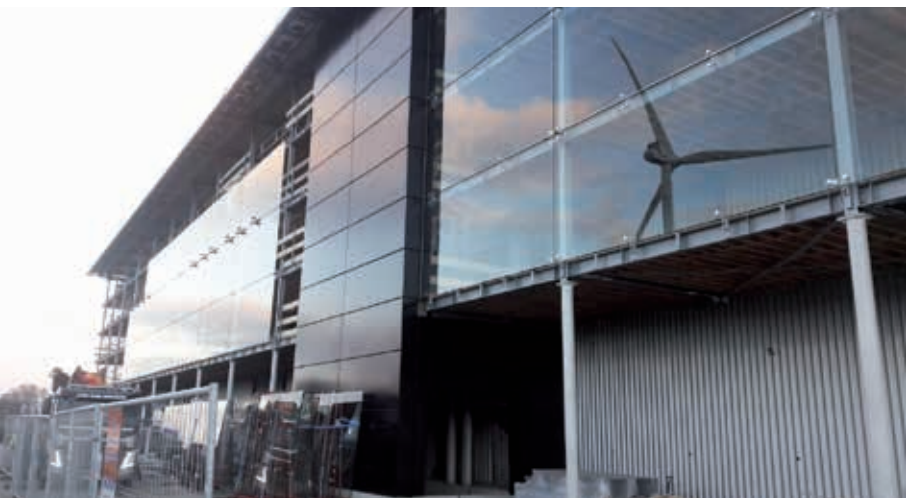
Het nieuwe dak heeft een stevige staalconstructie die rust op stalen kolommen. Bovenop de constructieve dakvloer bestaat de opbouw uit geprofileerde stalen dakplaten, isolatie en bitumen.
