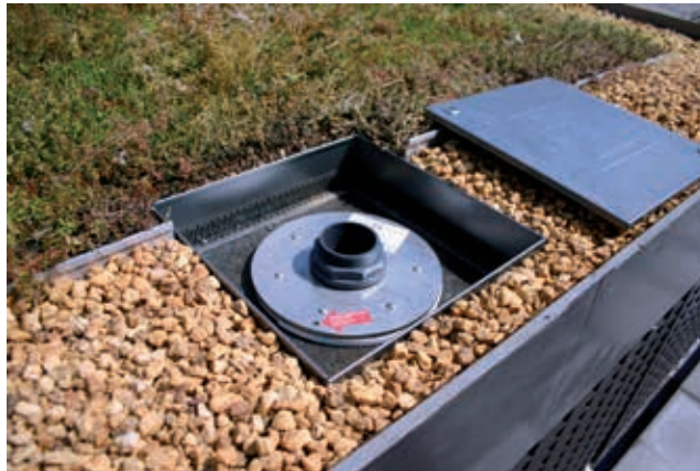
Op de afvoeren zijn de ZinCo Run-off control-elementen aangebracht.
