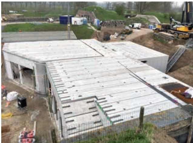
De dragende ondergrond van de verschillende daken bestaat uit kanaalplaatvloeren met daar overheen een druklaag (Foto: Van der Ven)
