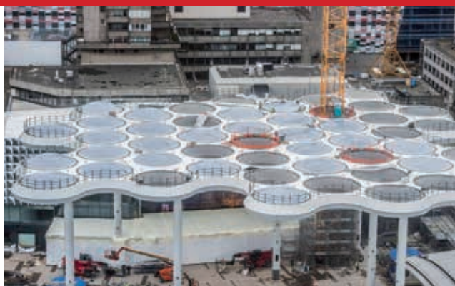
Zicht op de overkapping met de 49 sparingen, zoals weinig mensen de constructie zullen zien (foto: Buiting Staalconstructie).
