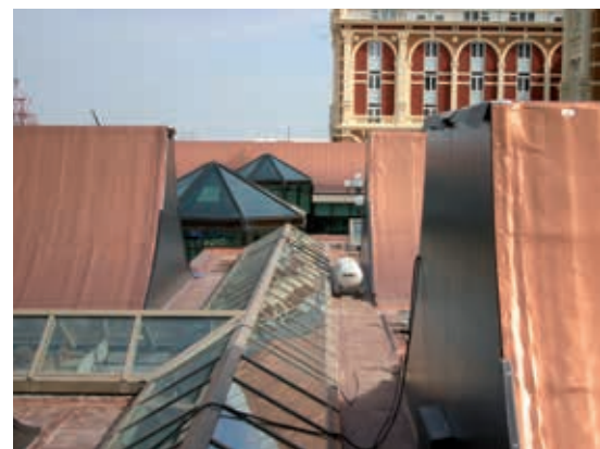
In de loopzones tussen de schaaldaken lagen lichtstraten die het aanbrengen van de nieuwe dakbedekking er niet makkelijker op maakten.
