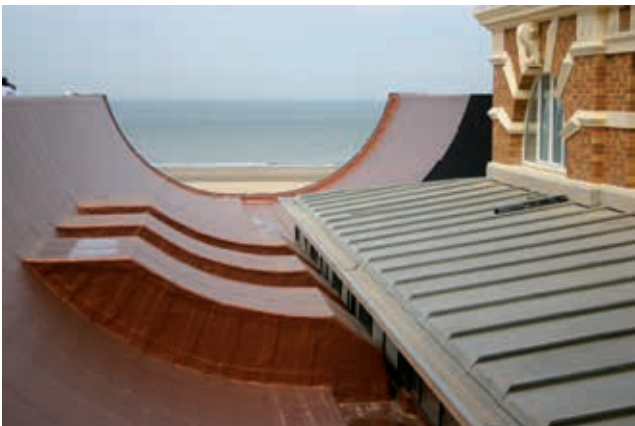
Aansluiting op het zinken roevendak en enkele vreemdsoortige dakdoorbrekingen, die ook om volledige inwerking vroegen.
