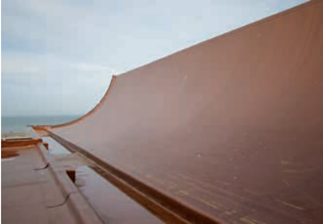
Detailopname van één van de schaaldaken met een gootzone en een aansluiting op een ander vlak dakdeel.
