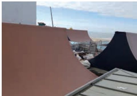
Op veel plaatsen op de daken was de werkruimte beperkt en was het woekeren en improviseren met opslag van materiaal en materieel.
