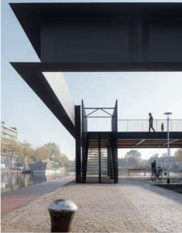
Op één van de hoeken wordt de zware dakrandconstructie niet ondersteund. De momentvastе verbindingen van de knooppunten van de staalconstructie vangen de krachten op.
