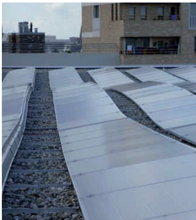
Hier is goed te zien dat dak 1 geknikt is met gootzones in het midden van het dak.
