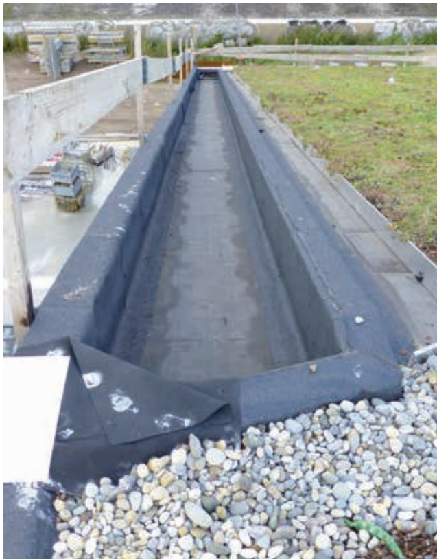
Aan de rand van dak 3a, waar op een lager niveau de daken 4 en 6a op aansluiten, is een goet gemaakt. Rechts zijn de voorgegroeiende vegetatiematten van het sterk hellende stuk van dit dak te zien.
