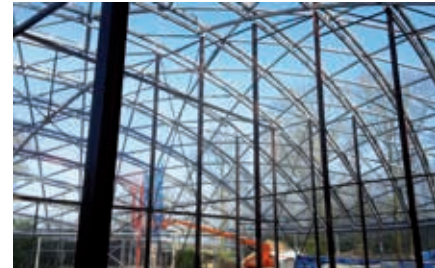
Tijdens de montage van de hoofdliggers en de schoorbuizen is het skelet tijdelijk opgevangen door drie steunconstructies.
