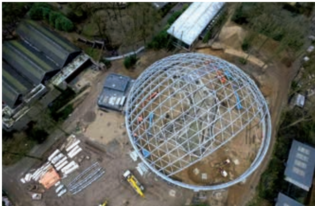
De dragende staalconstructie van de koepel met een diameter van 60 meter in aanbouw. Let op het ontbreken van de diagonale schoorbuizen in de nok: daar komen de twee ventilatieramen.
