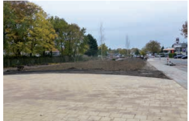
Aan het oostelijke uiteinde van het park is een groter deel bestraat om een goede ondergrond te bieden aan de Cougar helikopter, die hier komt te staan
