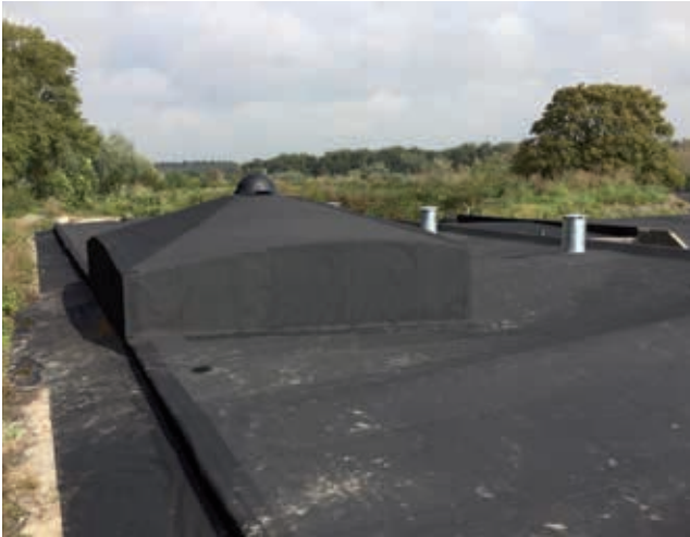
Ook de uitkijkoepel op het frontgebouw is opnieuw strak ingedekt met een EPDM toplaag
